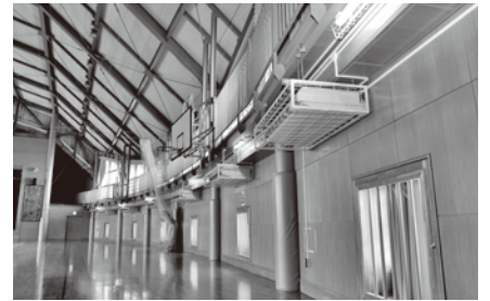
草加中体育館に整備されたエアコン
