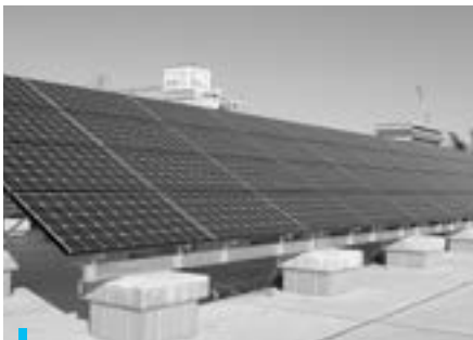
太陽光パネル
