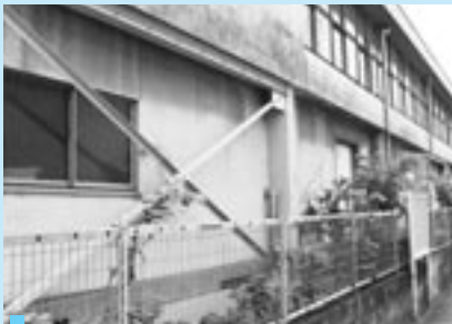
ブレースが設置された西町小の体育館
