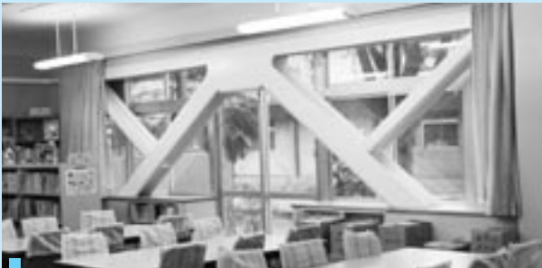
ブレースが設置された氷川小の図書室
