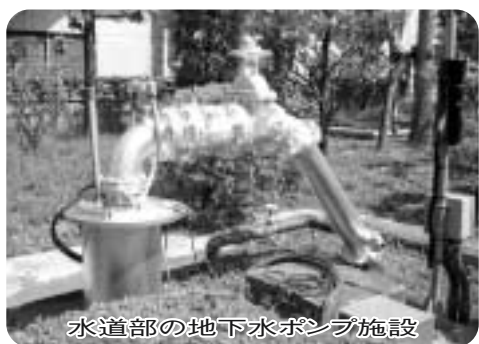
水道部の地下水ポンプ施設
