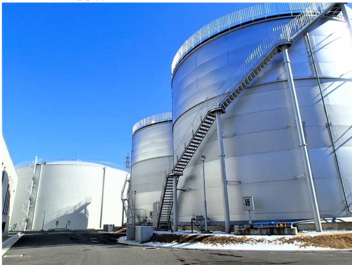
吉町浄水場のステンレス鋼板製配水池
