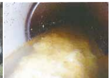
詰まりによる滞留
