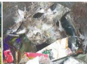
ゴミによる詰まり
