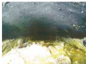
油脂等の固化による詰まり
