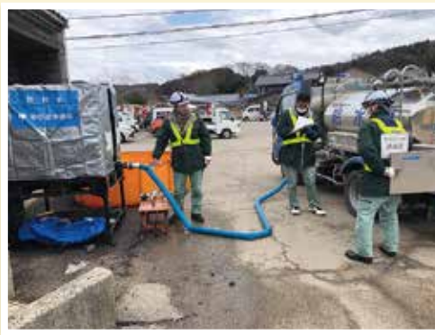
避難所に設置された給水タンクへの注水
