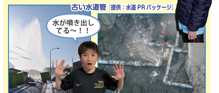
地震災害で水道管から水が噴き出す様子
