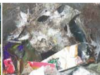
ゴミによる詰まり
