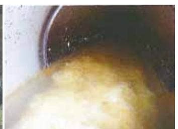
詰まりによる滞留
