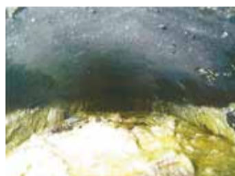
油脂等の固化による詰まり
