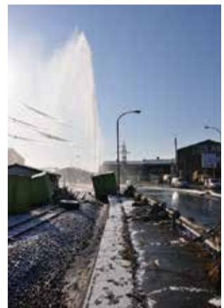
水道管破損で水が噴き出す様子 出典：水道耐震化プロジェクト
