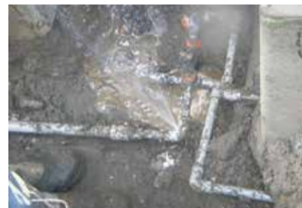
水道管から漏水している様子
