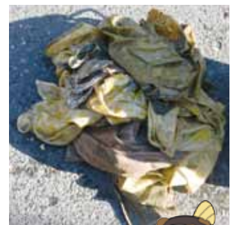
※マンホール内から発見された異物
