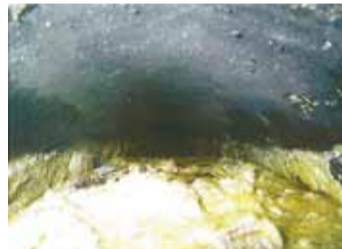
油脂等の固化による閉塞
