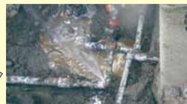
水道管から漏水
