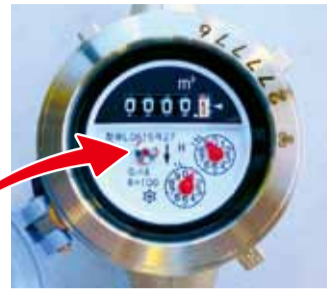
水道メーター
