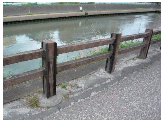
図 2-6：安全柵の老朽化による補修箇所
