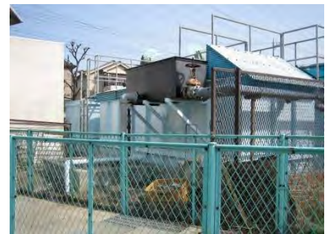
■辰井川浄化施設
