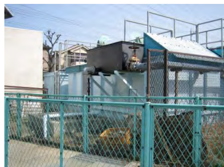
■ 辰井川浄化施設
