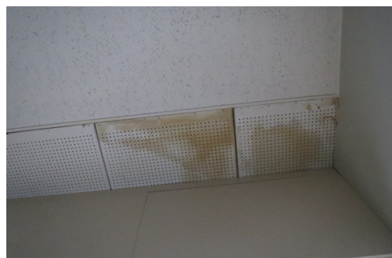
写真 2-1-1. 本庁舎の劣化（ひび割れ、雨漏り等）
