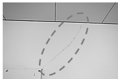
本庁舎の劣化（ひび割れ）
