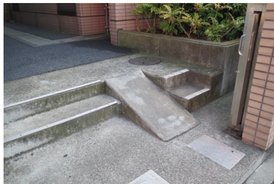
狭く急なスロープ
