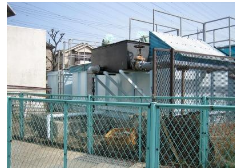
■ 辰井川浄化施設
