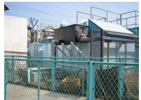
■ 辰井川浄化施設
