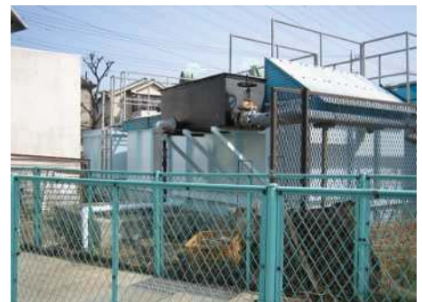
■ 辰井川浄化施設
